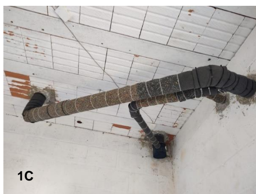
Figuras 1 - Imagens das amostras preparadas para as medições. A) Amostra I – tubo aparente (controle). B) Amostra II – tubo revestido com espuma expansiva. C) Amostra III – tubo envelopado com material de isolamento acústico convencional, fornecido pela Aubicon.
