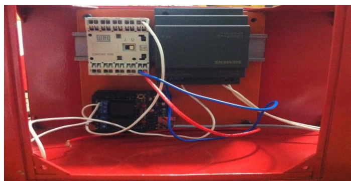
Figura 1. Comando elétrico com micro controlador, contactor e fonte de 24 Vcc para rebiteadeira.
