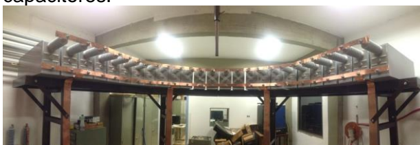
Figura 1. Banco de Capacitores.
